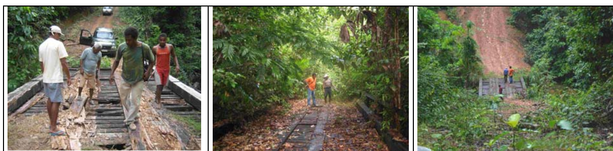
Figura 26 – Alguns trechos da estrada e pontes do ramal do Caraná Fonte: Acervo fotográfico do projeto Poraquê.
