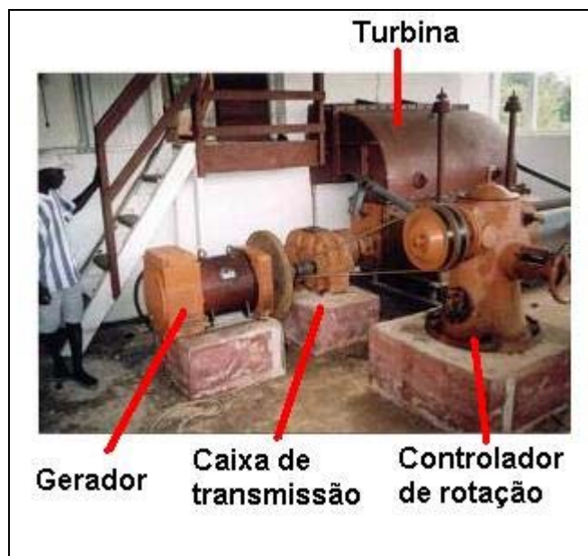
Figura 21 - Casa de força e os equipamentos eletromecânicos da turbina Fonte: Naipal (2004).
